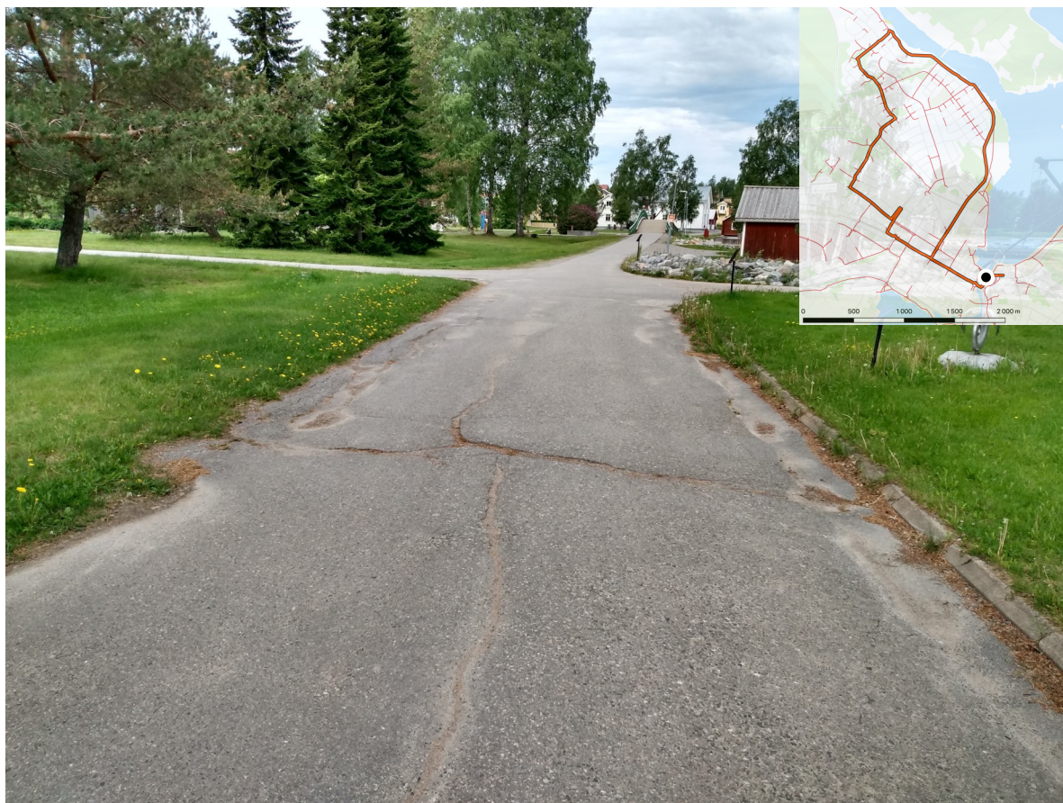
Foto 1. På flesta platser påträffas stora sprickor i asfalten längs cykelleden. Sprickorna utgör en säkerhetsrisk och försämrar komforten.
