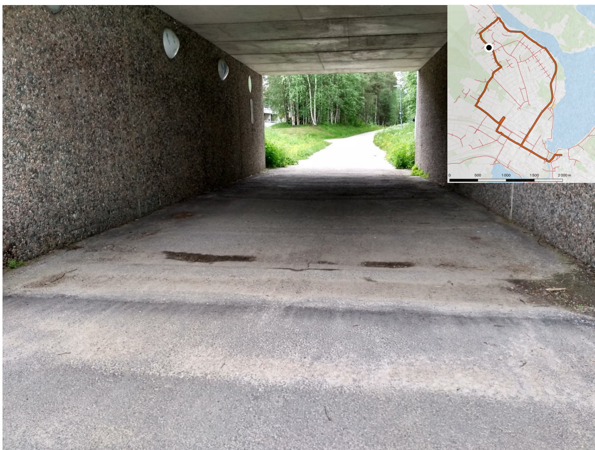
Foto 2. I tunneln under Fårövägen är asfalten som en tvättbräda. Det guppiga partiet kommer direkt efter en lång slutning. Den mörka tunneln innebär att det är svårt att se hur asfalten ser ut innan man är inne i tunneln. Här finns en risk att människor kör omkull.
