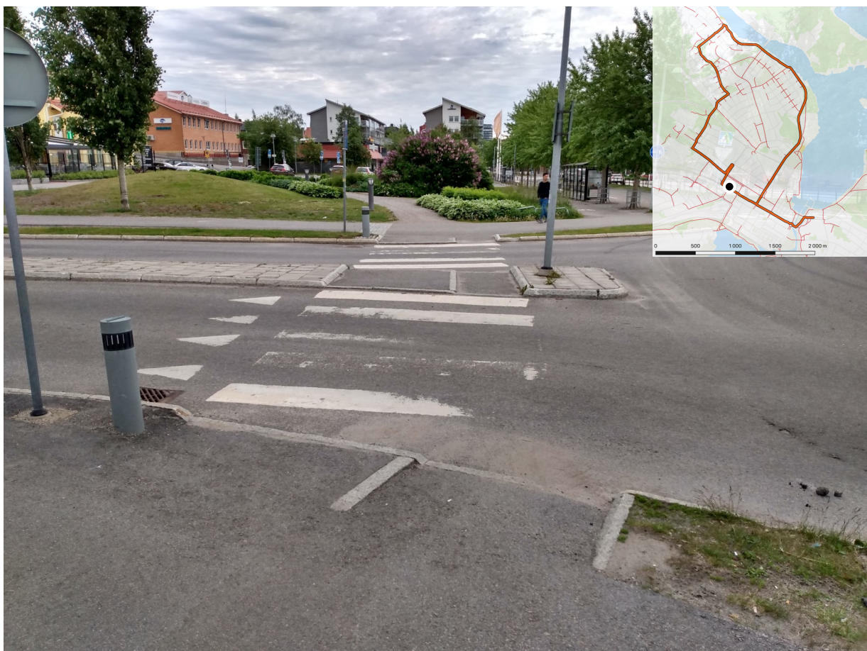
Foto 8. På den smala avfasningen vid detta övergångsstället på Sundsgatan är det omöjligt att passera en mötande cykel.
