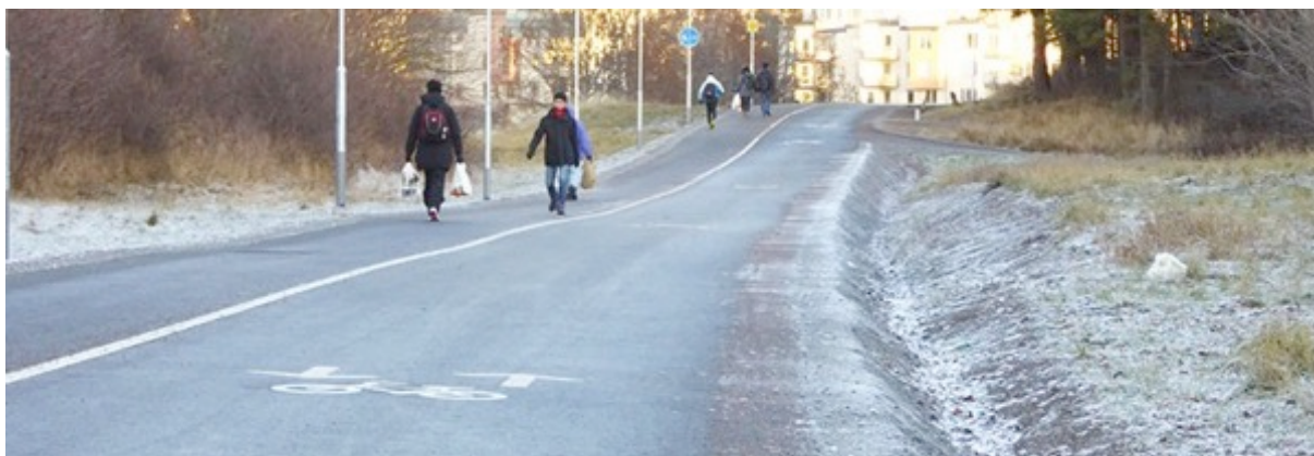
På en kort sträcka är cykelbanan upphöjd. Det är bra, dock är kanten väl brant.
