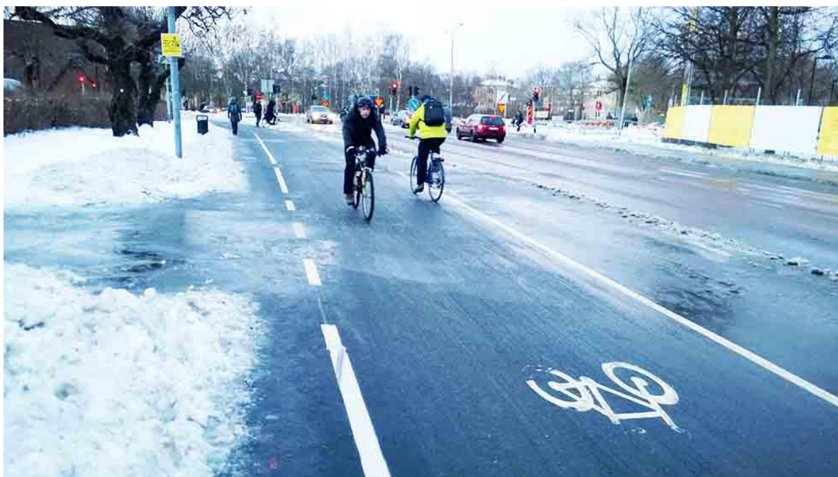
46 Utfarter, gångbanor och GC-banor som ansluter från en högre höjd bär ofta med sig smältvatten.
